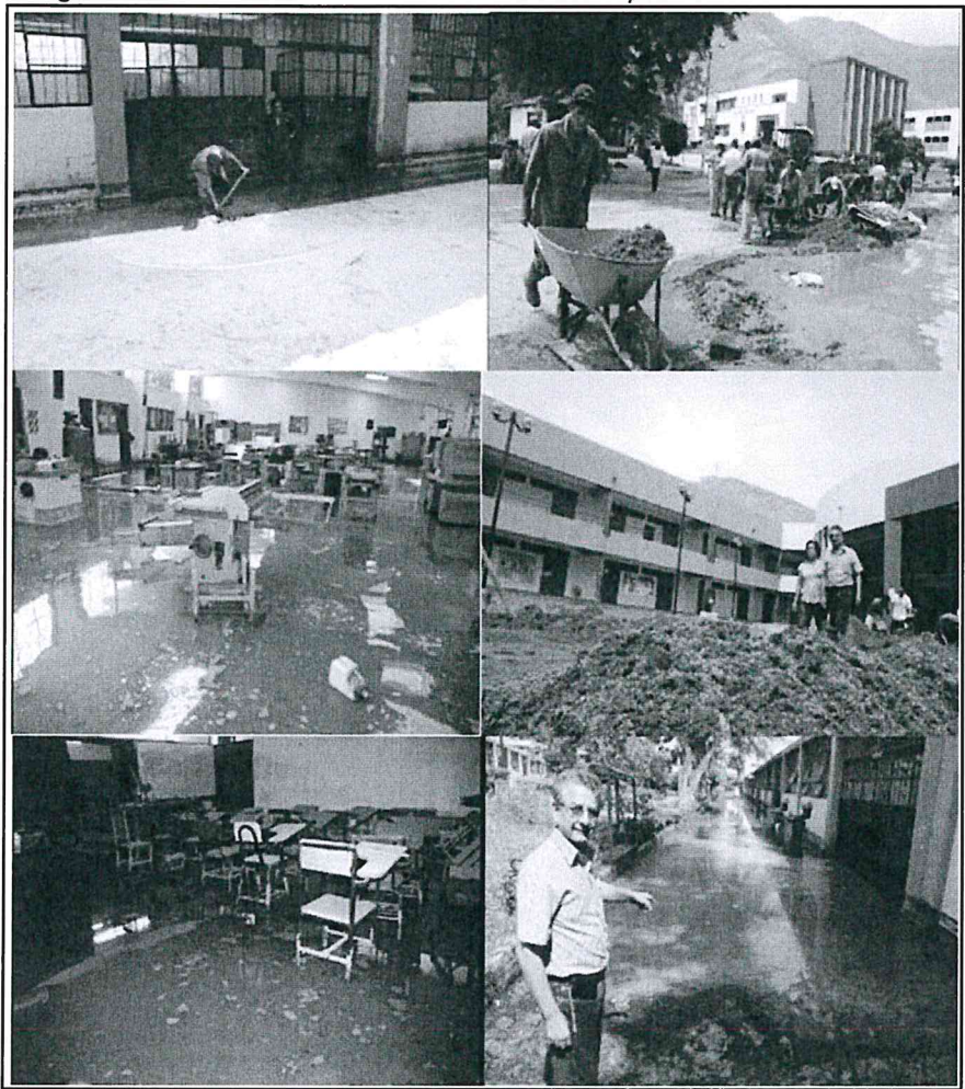
Figura N° 03: Fotos de los daños causados por huaicos en el 2012
